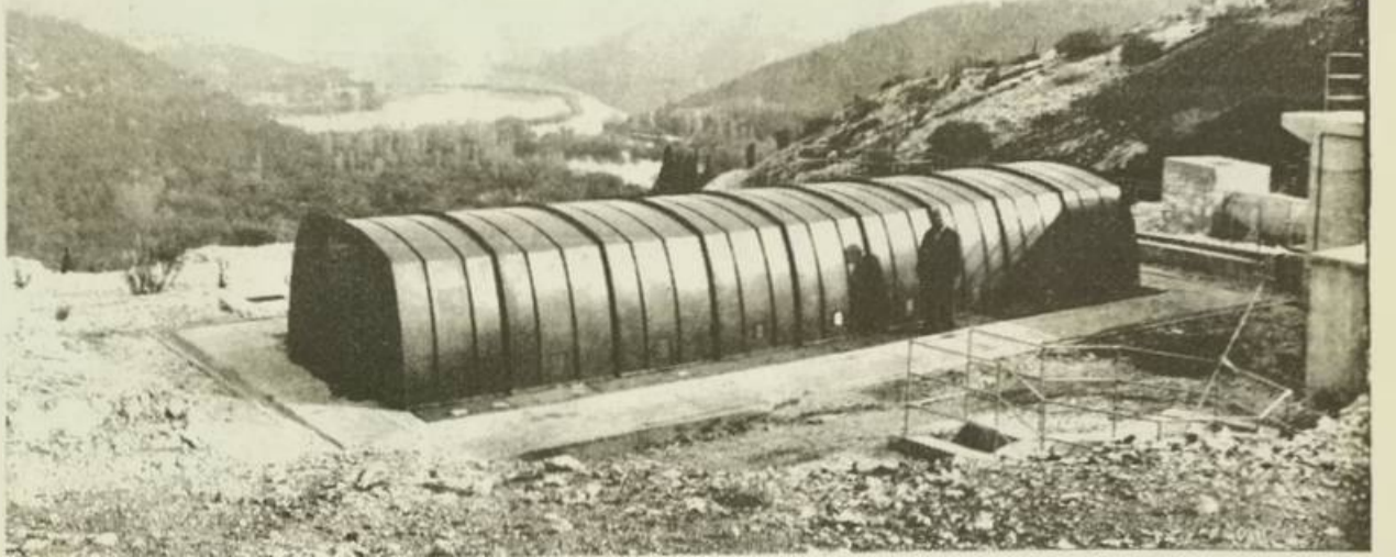
Biodisk na Lozovcu za pročišćavanje fekalnih (otpadnih) voda
